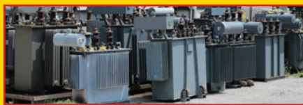
Trasformatori contenenti PCB.
